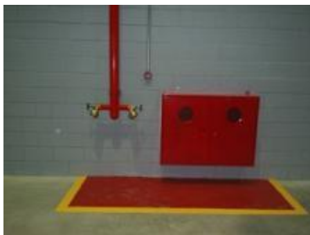
Fig. Sistema de hidrantes
