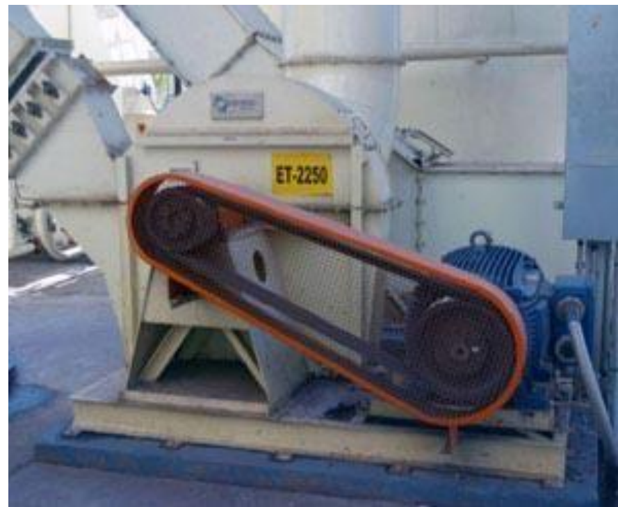
Exaustor de Transporte Pneumático de Caldeira de madeira. Distância de HP.
