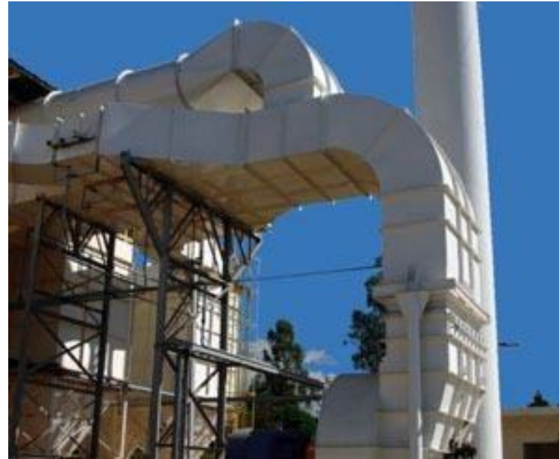
Exaustor sistema de Despoiramento de alumina. Potência 350.HP
