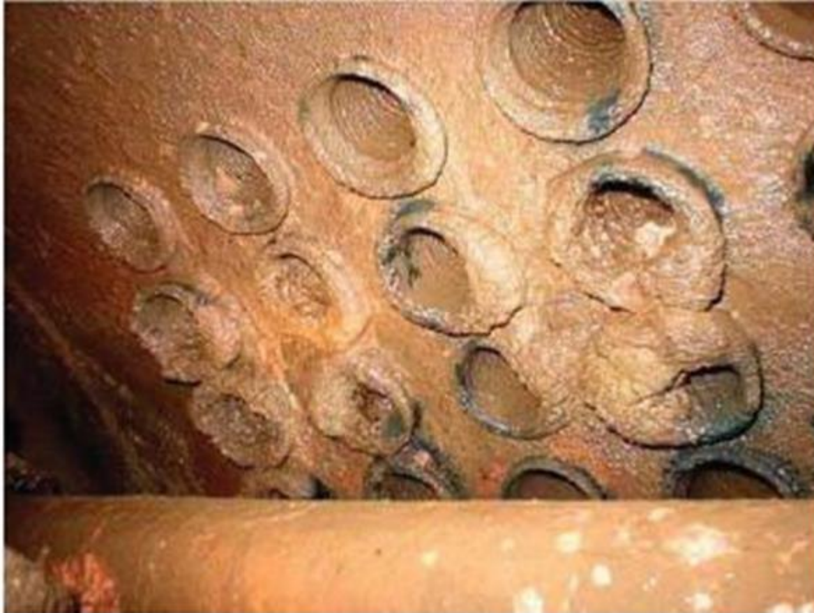
Caldeira aquatubular cheia de lama causando pela utilização de água bruta
