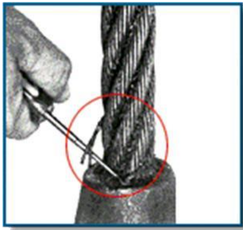
Figura 83: Cabo de aço com fio partido
