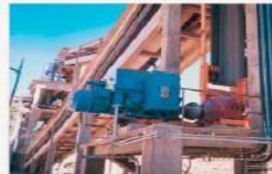
Fornecimento: MAF400, 331 kW, 6600 V, 6 pólos Aplicação: Correia transportadora
