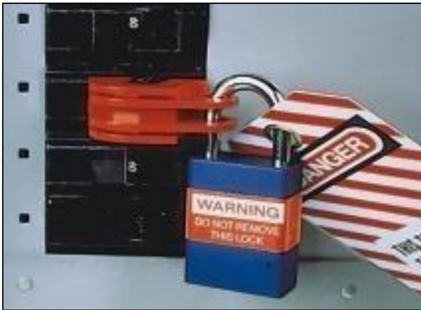
Bloqueio do disjuntor “lock out & tag out”
